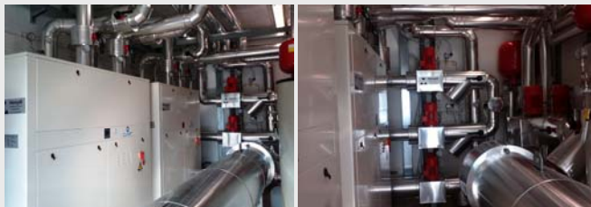
Depuratore Nosedo – Pompe di Calore dedicate acqua-acqua
