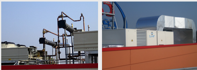
Caselle Center – Recupero da refrigerazione e Rooftop acqua-aria per le gallerie
