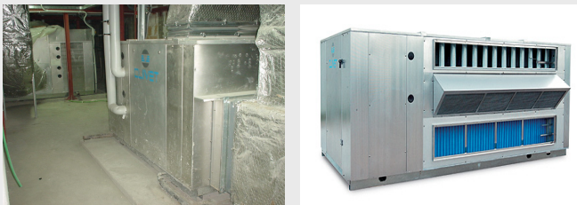
Warner Village Metropolitan – Vista unità Clivet disposta in vano tecnico e unità CSNX-H di Clivet.
