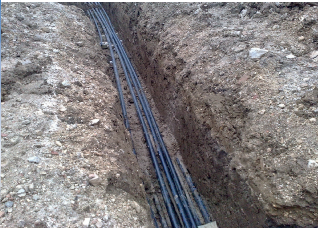
Le 55 sonde profonde 100 m e le 35 sonde profonde 120 m sono collegate da diversi km di tubazioni che realizzano una rete con ritorno inverso, funzionale al bilanciamento automatico delle portate (Studio Associato Graziani Sparapani).
