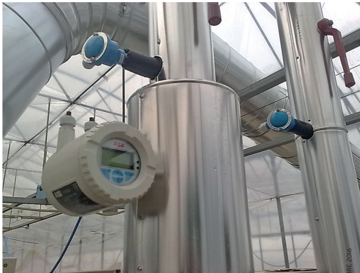
In luogo dei contabilizzatori della portata, che non restituiscono informazioni particolarmente significative sotto il profilo delle prestazioni, l'impianto dispone di un sistema che calcola in tempo reale il COP delle diverse macchine (Studio Associato Graziani Sparapani).
