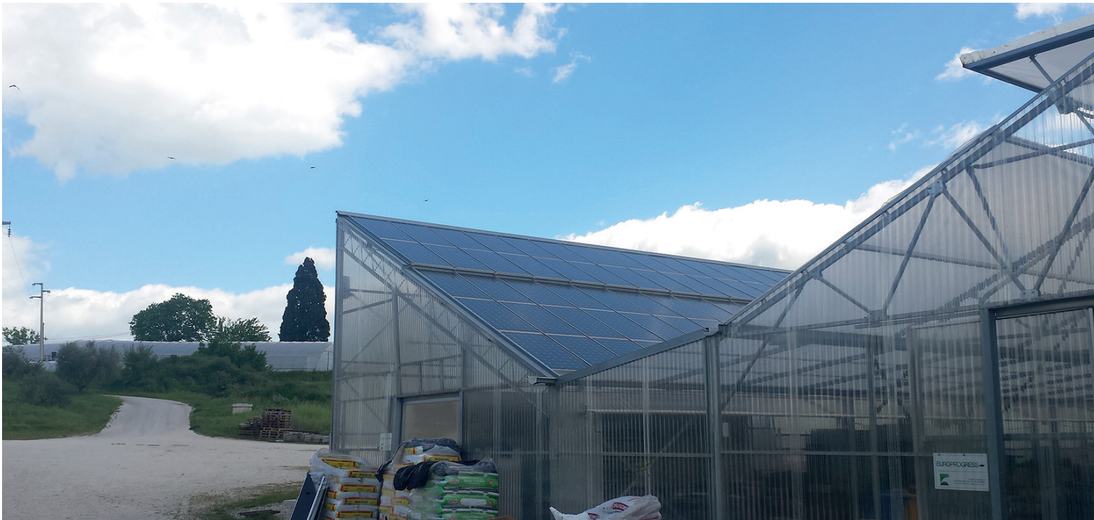
L'alimentazione elettrica delle rooftop è appannaggio di un campo fotovoltaico installato sia sulla copertura delle serre, sia sopra il nuovo capannone realizzato contestualmente al nuovo impianto geotermico (Studio Associato Graziani Sparapani).
